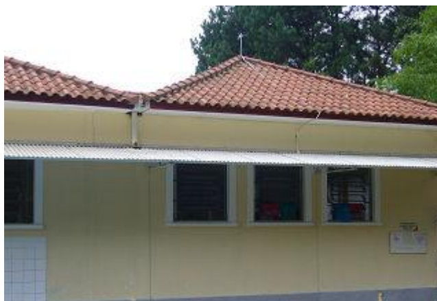
Sistema de proteção contra descargas atmosféricas instalado no prédio de educação infantil
